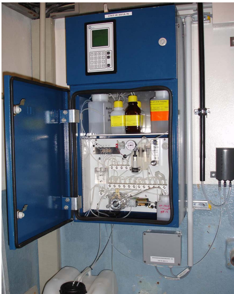
(Installation eines Micromac-C für freies Cyanid, integrierte Abtrennung durch Stripping)
